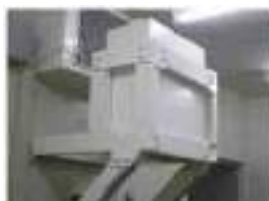
サイクロトロン室遮蔽体
