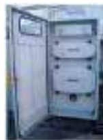
排気フィルタユニットの設計・製作・設置
